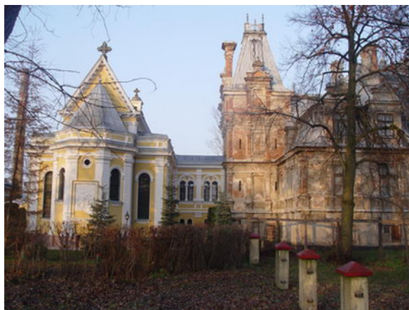
Zły stan pałacu kontrastuje z odnowioną kaplicą
