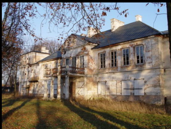
Zdewastowany pałac w Mordach
